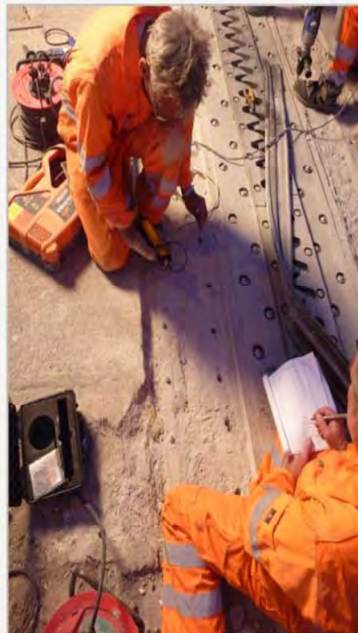
Kontrol af huller mht. afstand til armering
