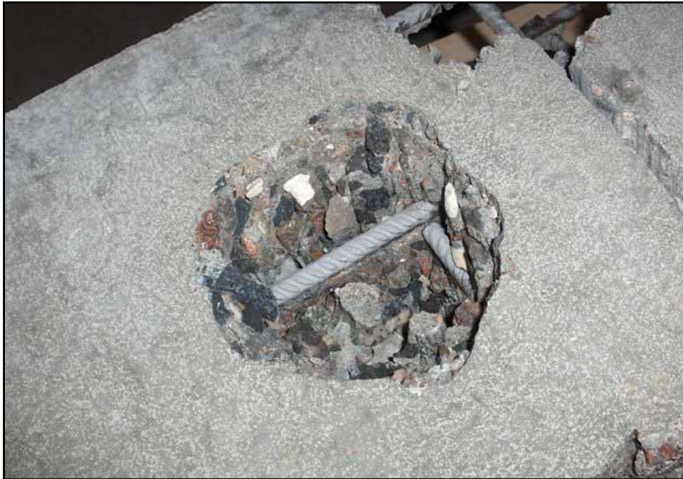
Fritligning af armeringsjern / Skader
