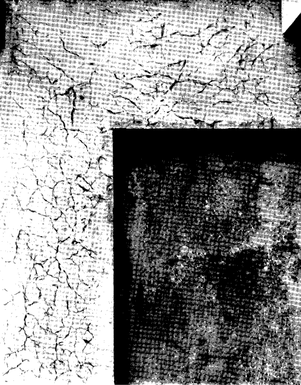
Eksempel 2. Varmehærdet altanelement med netrevnemønster. De første revner er opstået på grund af store temperaturforskelle mellem betonens indre og ydre dele under hærdningen. De er senere udvidet af alkalikiselreaktioner og frost. Frosten vil fortsætte nedbrydningen så længe revnerne er åbne for vandindtrængning. Alder ved fotografering 3 år.
