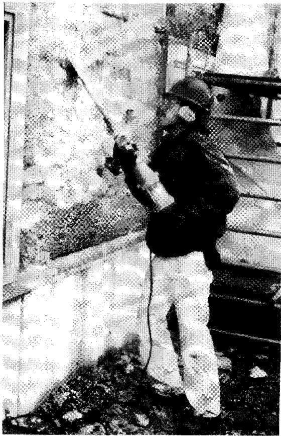
Figur 2. Afretning af lecaoverflade med spademejsel er ergonomisk belastende. Støjniveauet ved udstyret er 112 dB(A) og i bygningen max. 78 dB(A).
