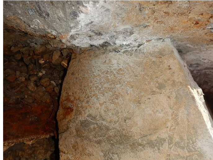
Skade på skråpæl ved fender F6
