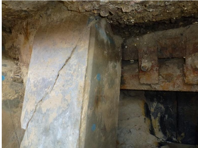
Skade på skråpæl ved fender F7
