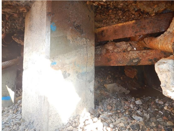
Skråpæl ved fender F7. Hjørnet af pælen er sprængt af.
