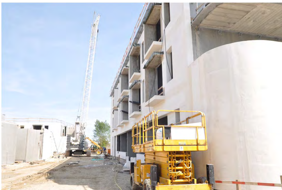
Karlsunder Plejecenter, med karnapper indbygget i facader
