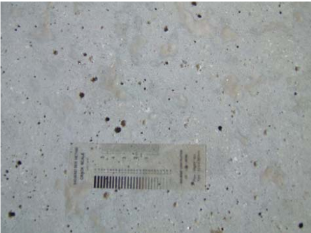
Fremkomst af huller efter slibning af SCC-Beton
