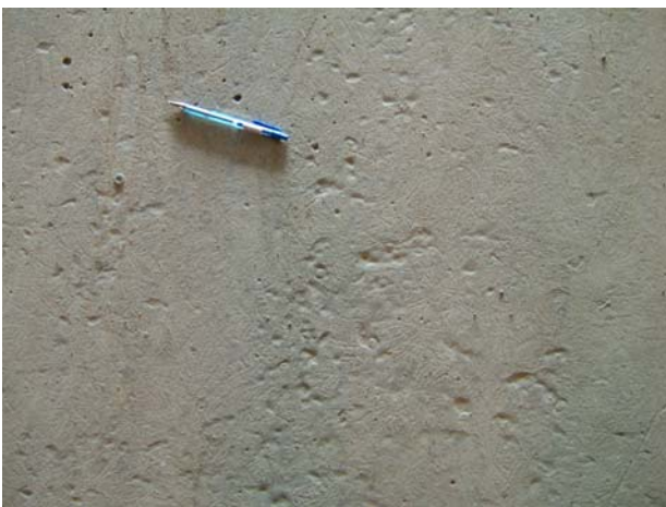
Sleben overflade på SCC-Betongulv der er blevet juttet for tidligt
