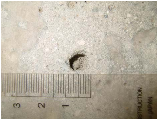
Huller i SCC-Beton gulv med lodrette vægge
