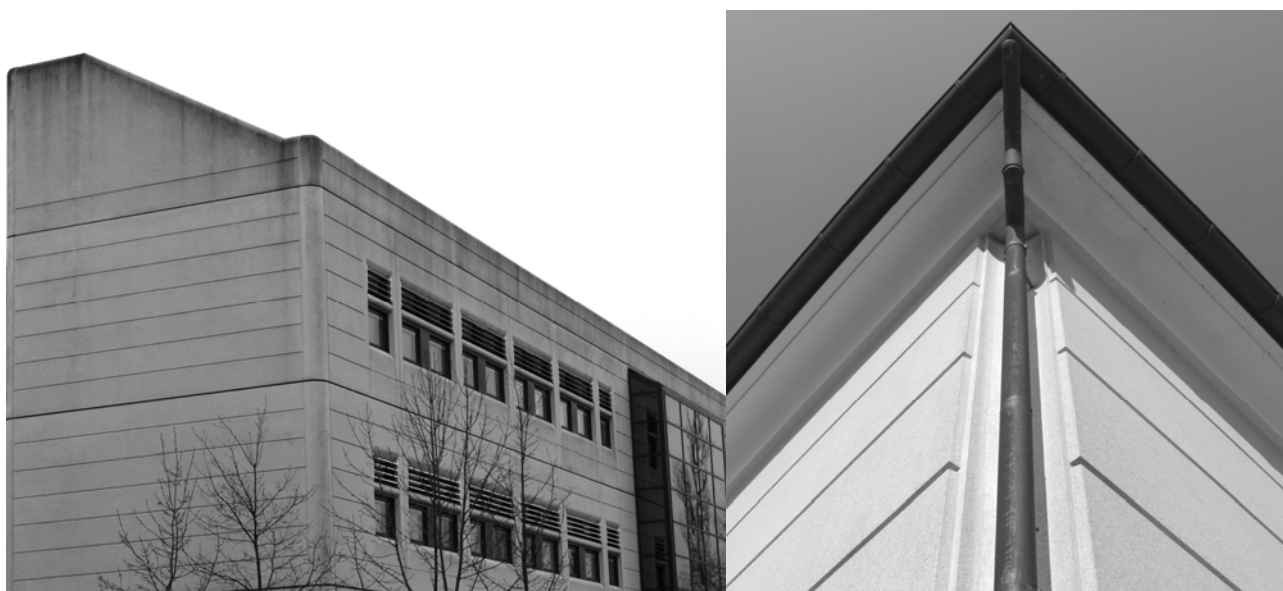
Figur 1: Hvis forventningen var et uændret udtryk, ville forventningen ikke være indfriet i eksemplet til venstre, mens den er det i eksemplet til højre. Designet påvirker hvordan snavs og vand vaskes ned over facaderne og dermed i hvor høj grad afrensning er nødvendig for at fastholde et uændret udtryk. De to bygninger er begge ca. 10 år gamle.
