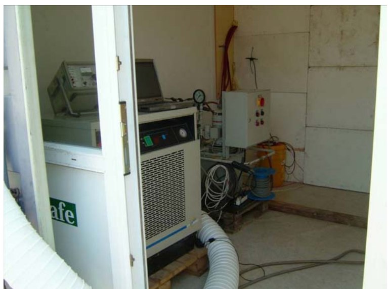
Hydraulik- og køleanlæg udvikler så meget varme, så temperaturen i dette rum kan blive op til 40°C. Bagest ses den polystyrolvæg, der isolerer ind til prøveopstillingen.
