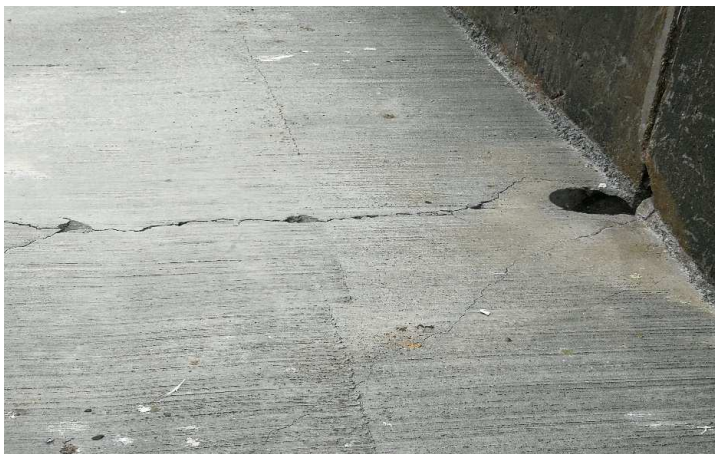
Revne opstået umiddelbart efter støbning - 2018
