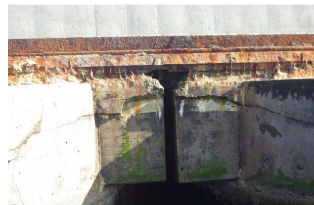
Forvitring og revnedannelse mellem to sænkekasser
