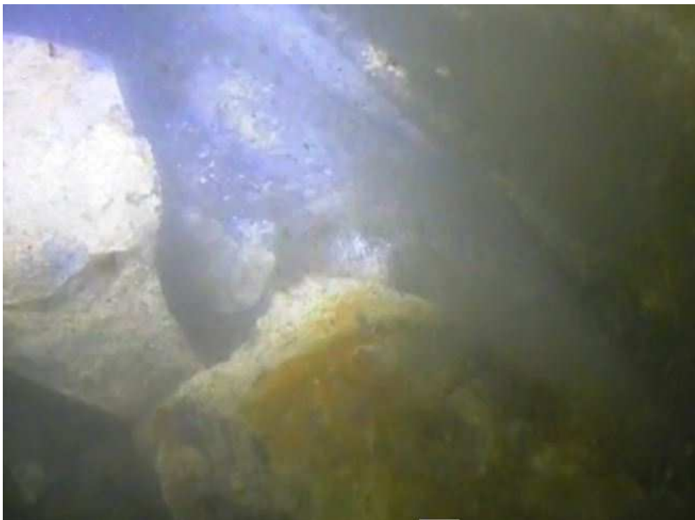
Dykkervideo - Kammersluse – smuldret beton under portskinner.
