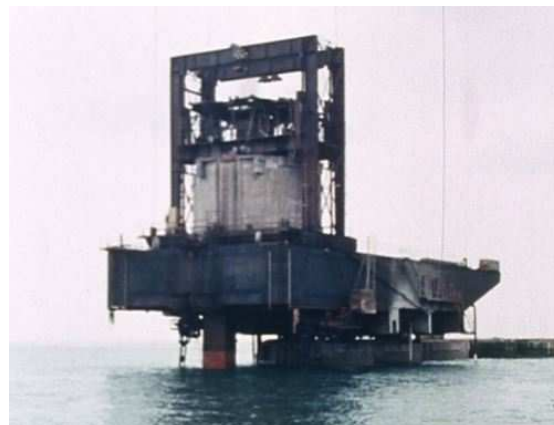
Sætning af sænkekasse med 110 t kran hvilende på de to sidste kasser
