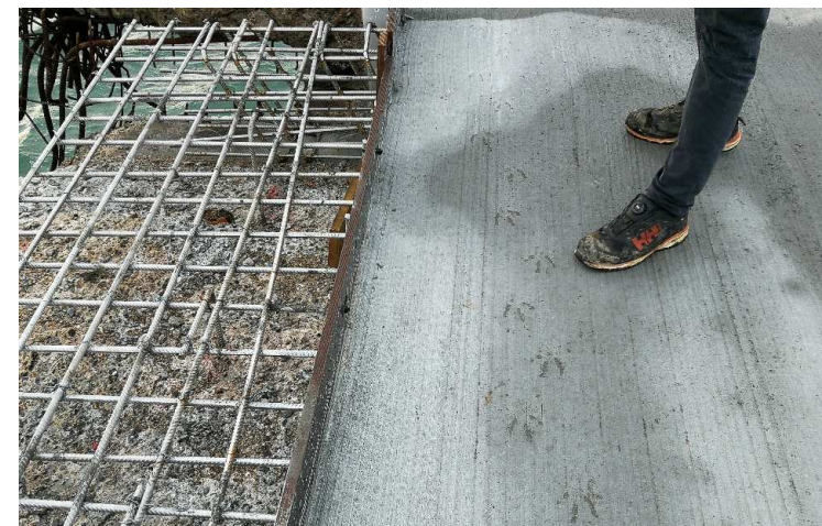
Mågespor i betonen - 2019
